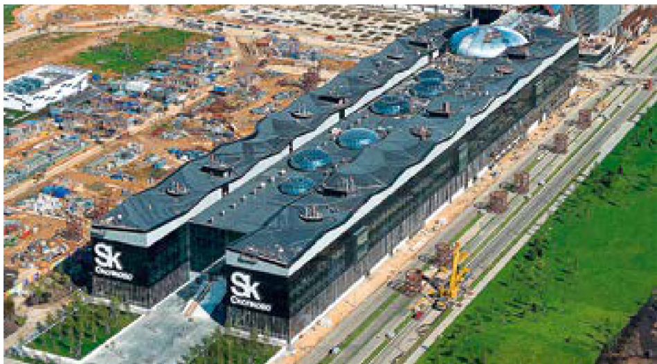
Grand Prix lamekatuste kategoorias: Skolkovo tehnopark, Venemaa. Ehitaja LLC "Zelenaya Krovlya". Materjaliks TechnoNicol bituumenrullmaterjalid Uniflex Vent EPV, Technoelast EKP.
