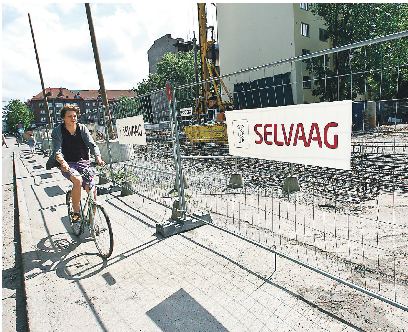
SELVAAG Sakala OÜ arendatav büroohoone Tallinna kesklinnas peaks valmis saama aasta pärast. FOTO: ANDRAS KRALLA
