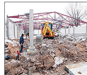
Praegu on püsti vaid osa kauplusehoone seinu ning katusekonstruktsioonid. ELMO RIIG
