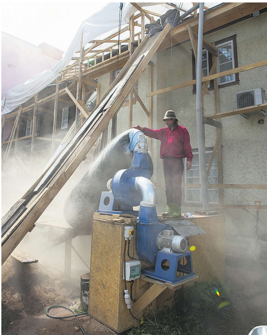
Tallinna tänav 8 maja hoovipoolses osas käib vilgas töö, olgugi et tolmuoti juures tegutsev ehitaja Imre Tael pole linnavalitsuselt hoone rekonstrueerimiseks ehitusluba saanud.
